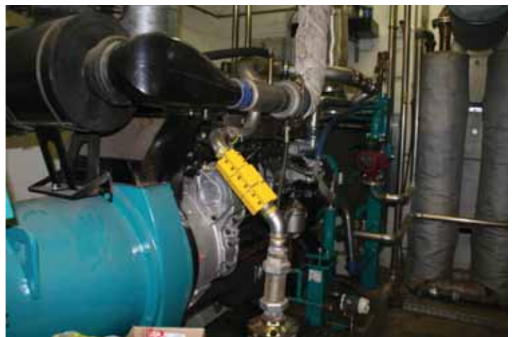
Un des modules C1 installés sur une arrivée de gaz d'un système biogaz
